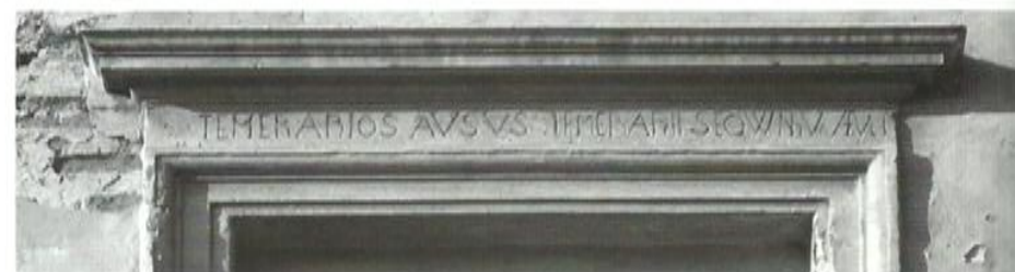
42. Zamek w Żółkwi. Inskrypcja nad oknem „C” elewacji pałacu od ogrodu. Stan w 2007. Fot. Autor.
