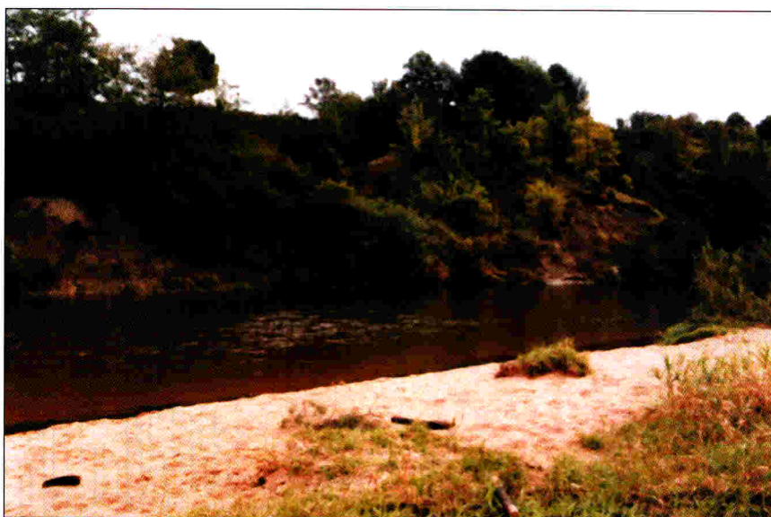
Fot. 1. Osuwisko w dolinie Warty koło Konopnicy (fot. G. Bezowska) Photo 1. Landslide in Warta river valley near Konopnica (by G. Bezowska)
