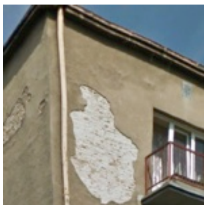
ubytki w tynkach (Sosnowiec)
